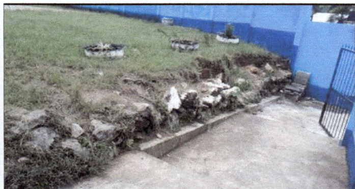
Foto 3: se observa que el muro de contención que esta junto al acceso al establecimiento se encuentra en malas condiciones.
