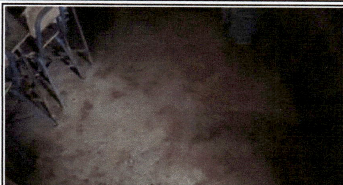
Foto 2: se observa deterioro del piso de concreto, del area continuo a la dirección.
