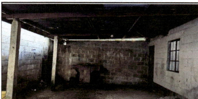
Foto 6: se observa que como las laminas en el corredor de la cocina estan en muy malas condiciones, por lo que es necesario reemplazarlo.
