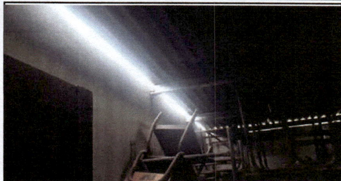
Foto 1: se observa como ingresa la luz através del techo deriorado de la dirección, que vez se usa como bodega.
