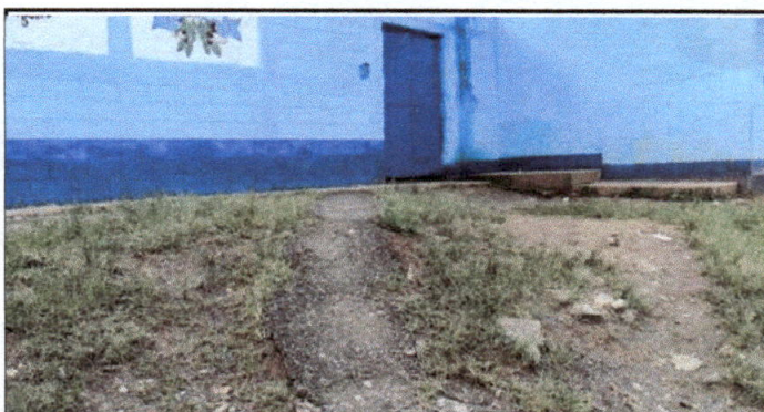
Foto 4: Se observa que en la entrada principal el poco concreto que habia se ha deteriorado por lo tanto hay que reemplazarlo
